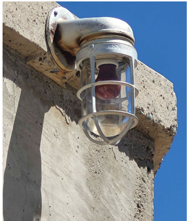
Fig 9. Fotografías de las luminarias existentes en las instalaciones de Cerro Tololo (AURA-NOIRLab).
